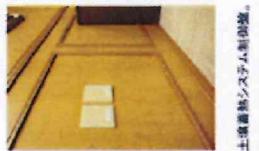
床から30cmほどの高さに温度センサーを設置。足元が冷えたとすぐに自動で対応します。
